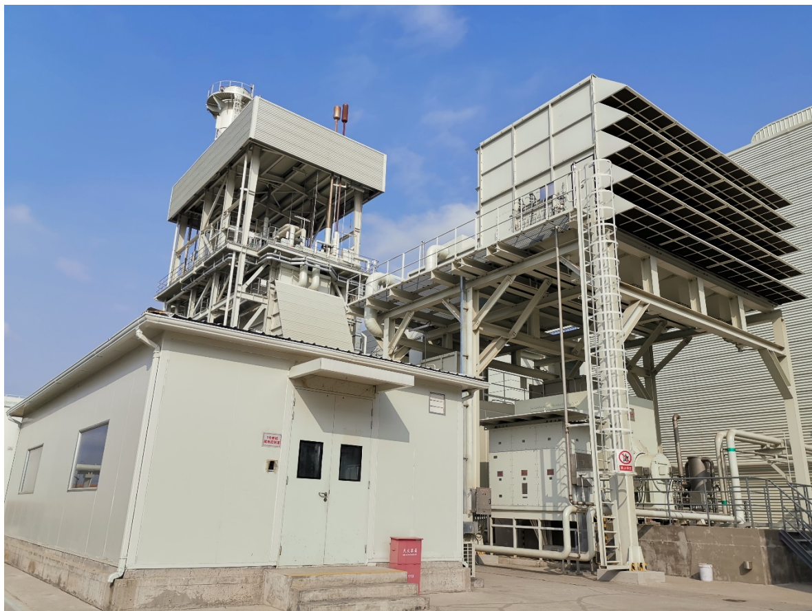
天然气分布式能源项目 1 号机组圆满完满负荷试运行 -哈尔滨广瀚动力技术有限公司
