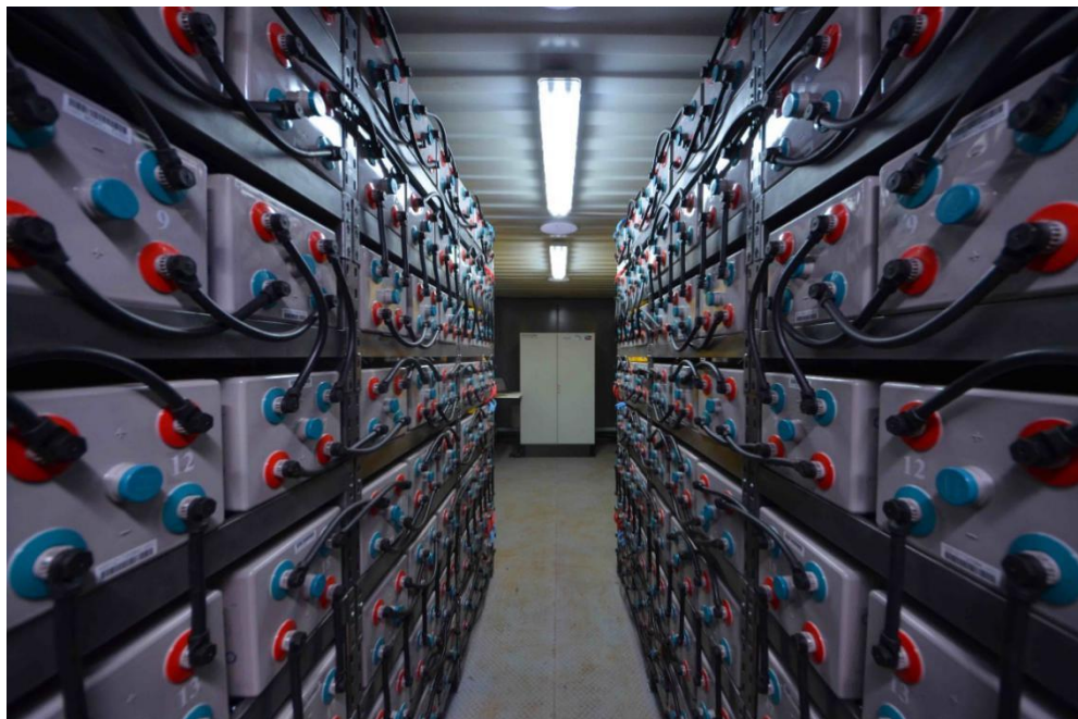
（储能站中的阀控式铅酸蓄电池，图片源于 OFFGRIDENERGY）
