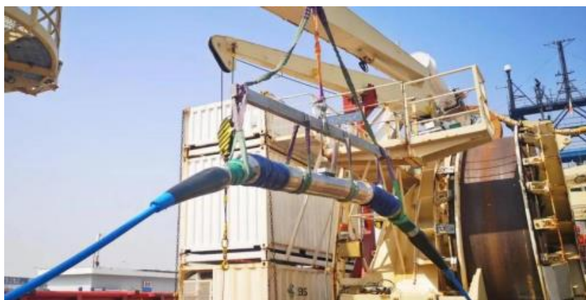
图 15 全球首个 16 纤对中继海底光缆系统
