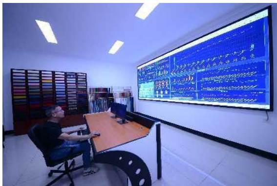
图：印染企业数字化车间控制室
