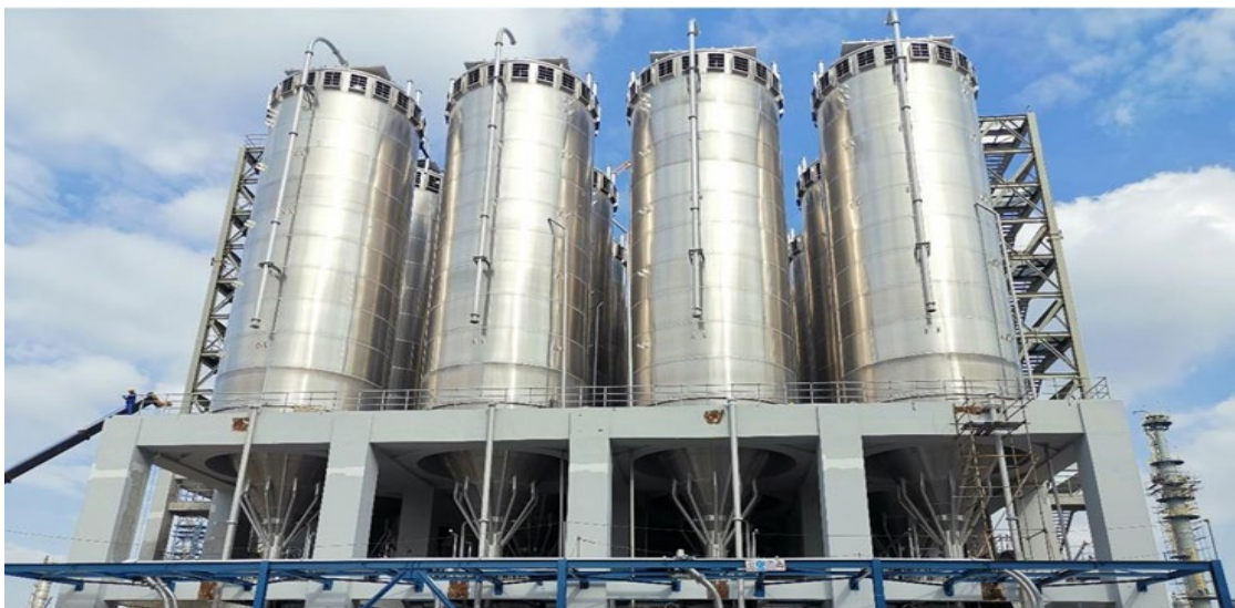
粒料掺混系统实景图
