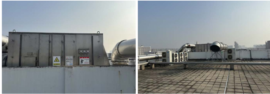
>> 废气处理措施
