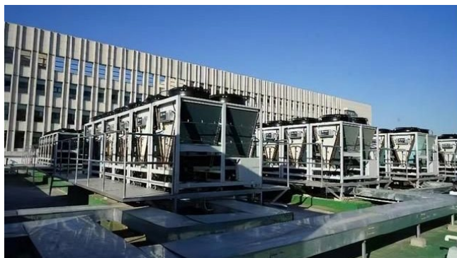
中国联通天津空港数据中心高效空调系统
