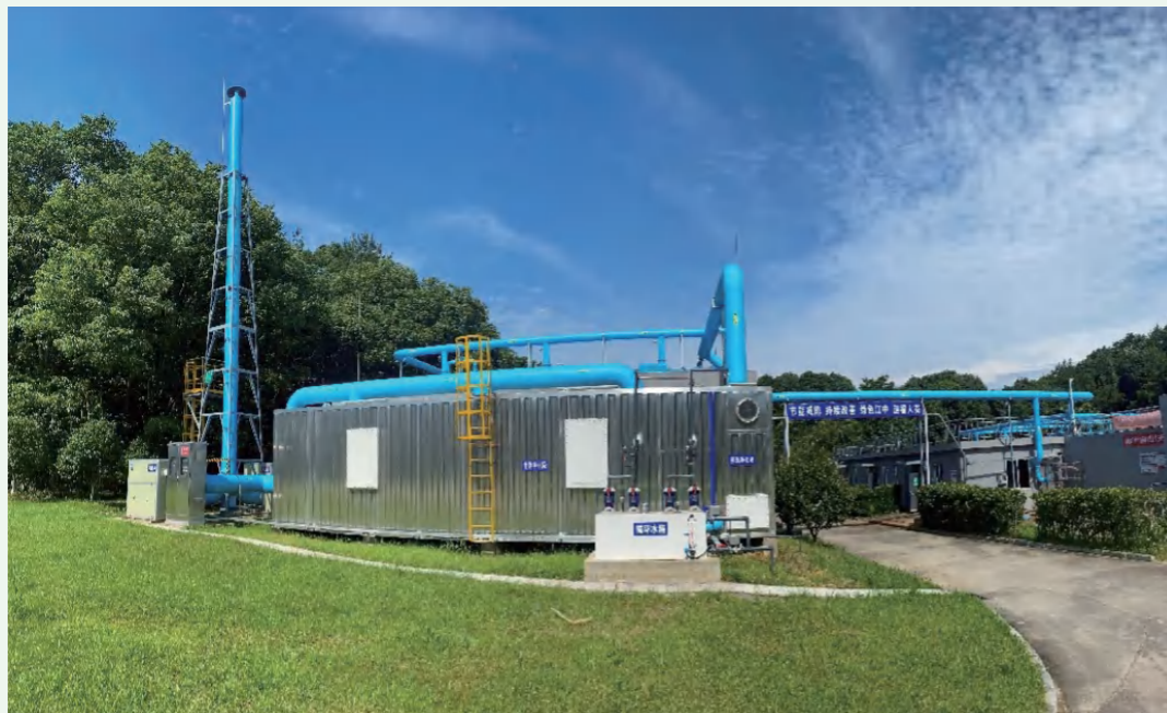
污水处理站废气加盖除臭装置
