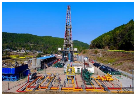
八角场气田角 76 井场
