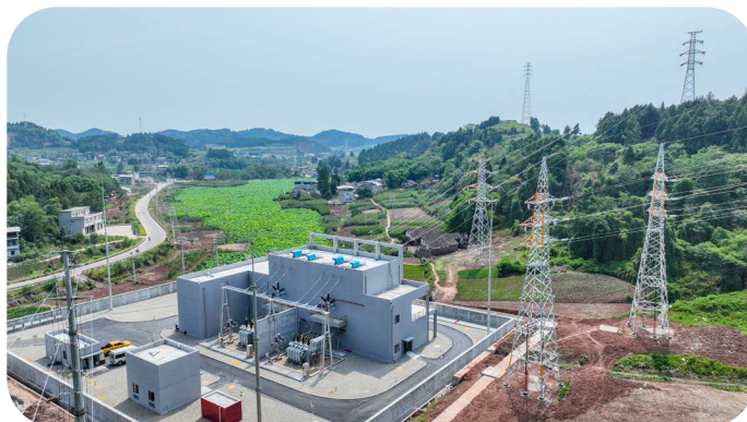
110 千伏白马变电站投运
