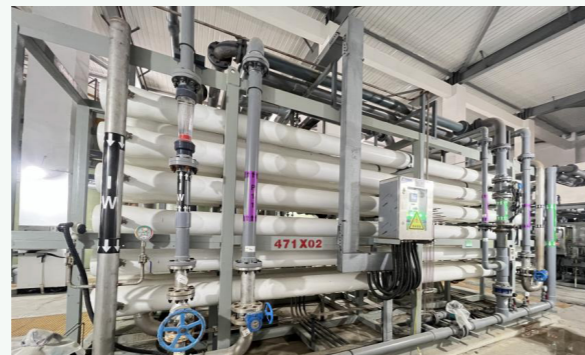
高盐废水回收装置
