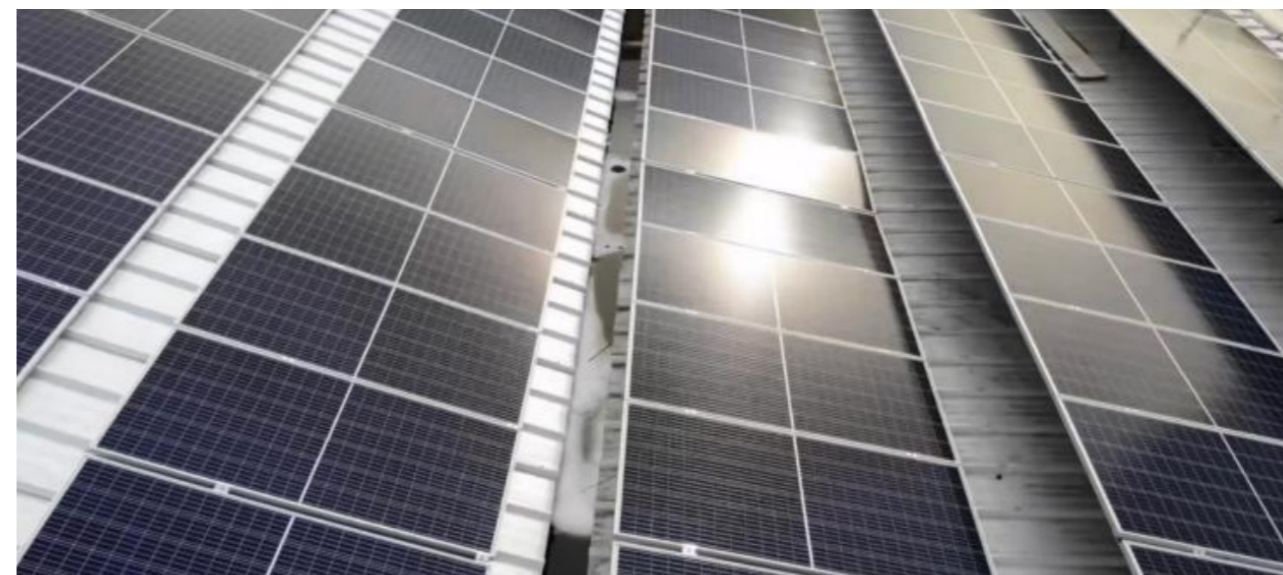
镇江仓库太阳能光伏面板
