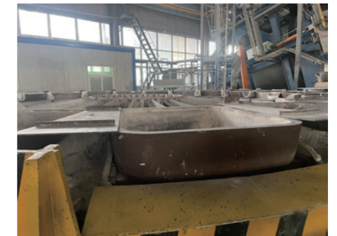
图：中孚实业污泥干化装置
