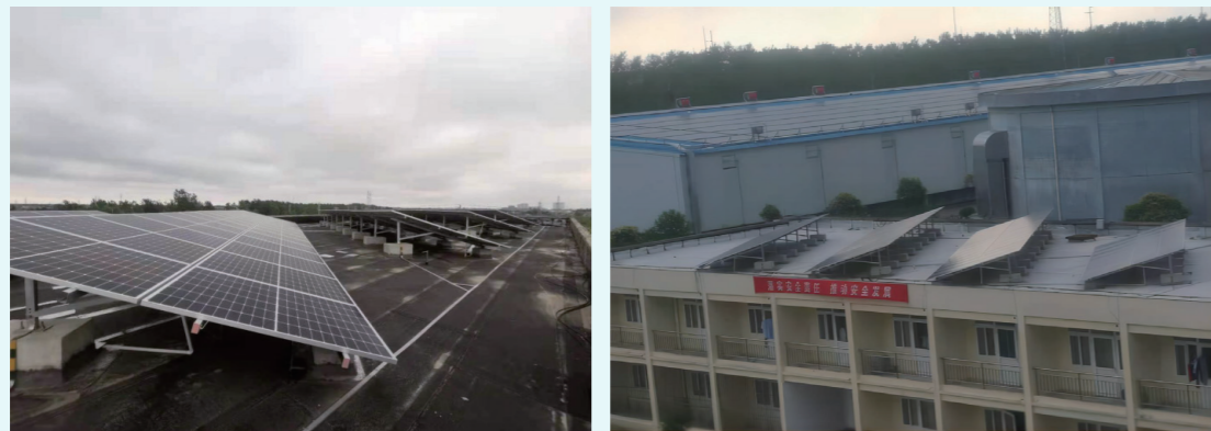
屋顶分布式光伏发电系统
