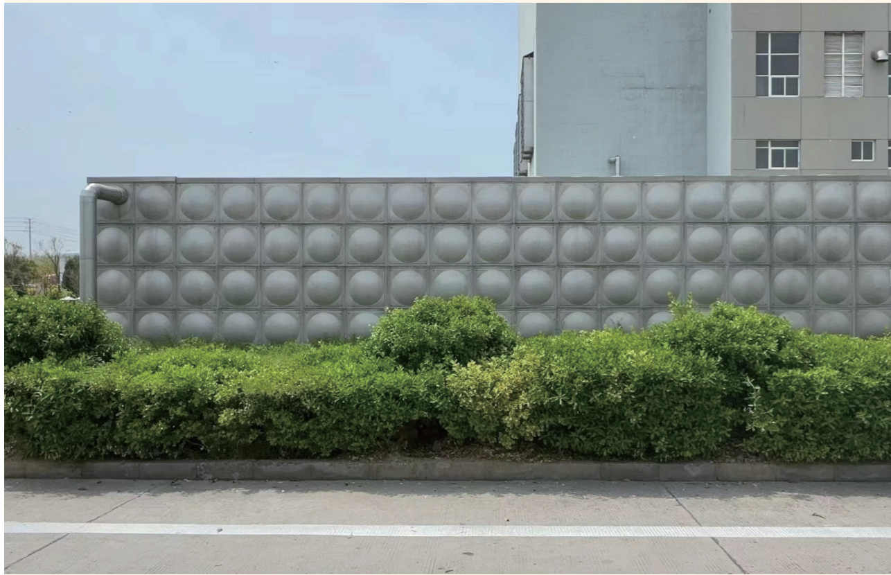
冷凝水回收利用装置
