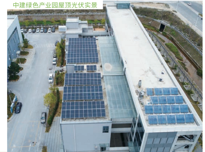
中建绿色产业园屋顶光伏实景
