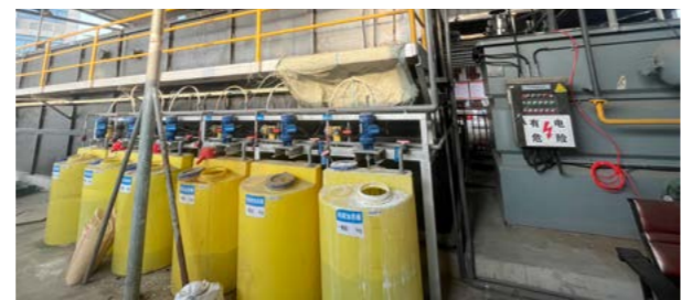
福建片仔癀化妆品有限公司污水处理站
