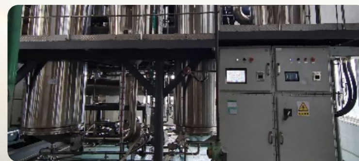
植物药产业园双效纯电蒸发器
