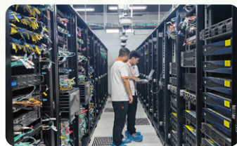
金域医学总部大楼机房
