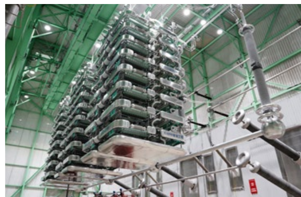
上海南桥换流站CLCC换流阀现场
