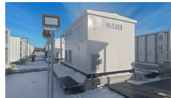
河北承德15MW/30MWh储能项目
