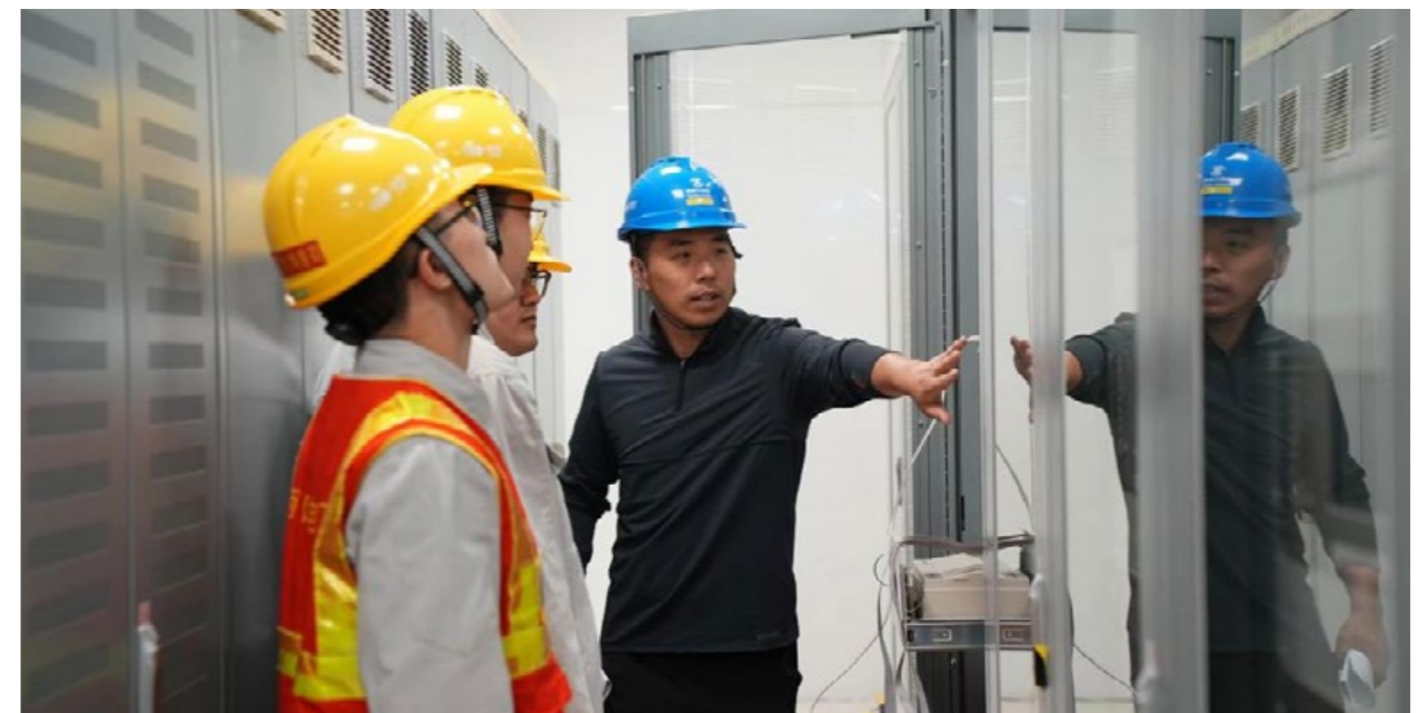
稳定公司工程师开展现场联调试验
