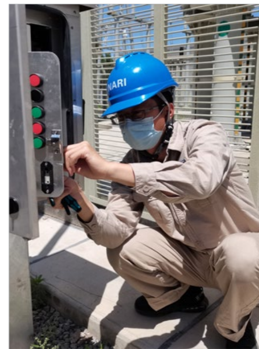
技术人员开展现场调试
