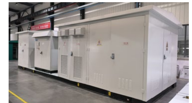
扬中2MW构网型储能微电网项目
