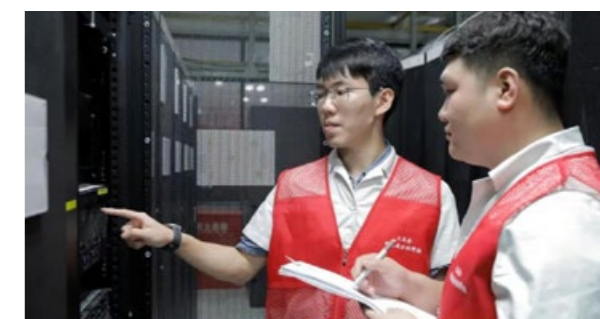
网络安全专家在保电现场开展系统安全巡查
