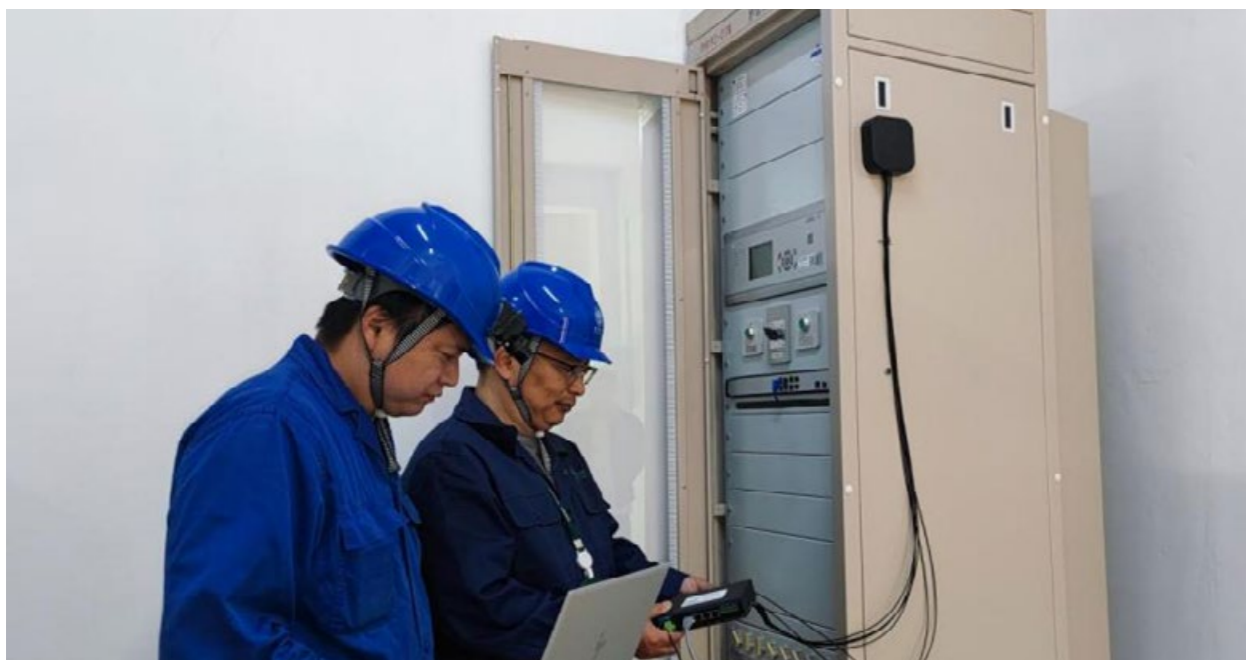
信通科技技术人员在现场开展电力业务5G轻量化承载测试
