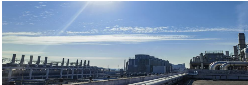
废气治理设施
