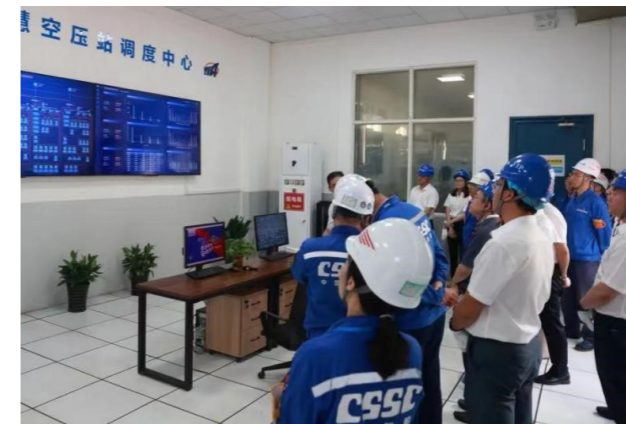
智慧空压站调度中心
