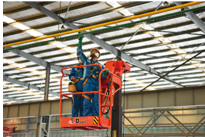
▲ 中化橡机工业管道维护专项行动
