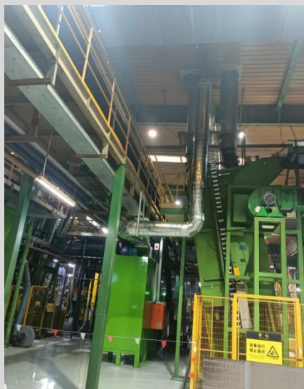
抽墨管道走向
