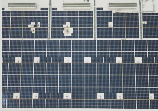
安徽宝钢制罐厂房屋顶分布式光伏发电系统
