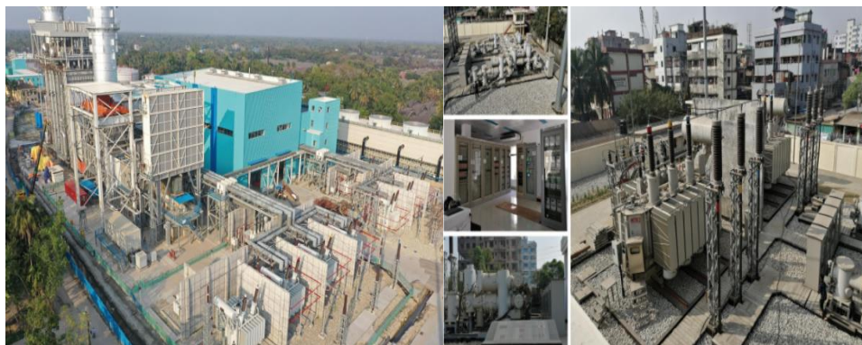
图 7：孟加拉 300MW 联合循环电站
