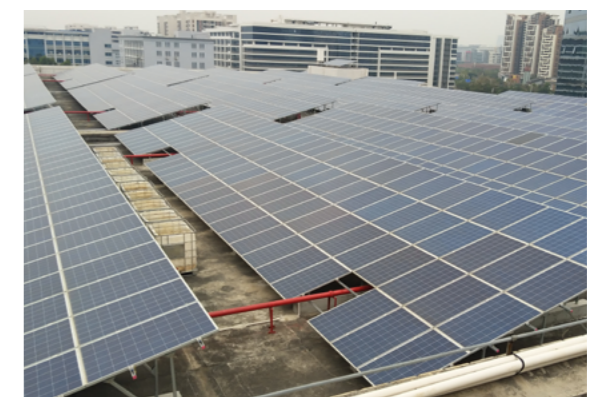
屋顶光伏现场照片
