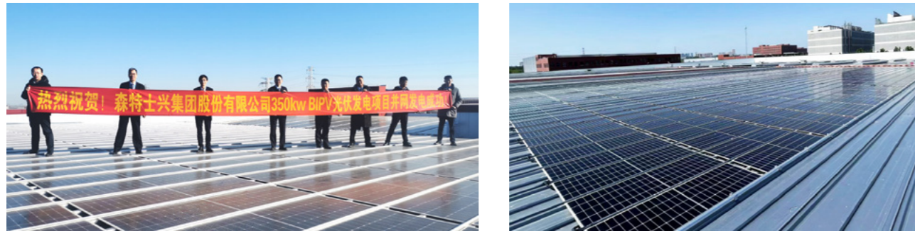
集团总部办公楼、生产基地屋顶光伏电站
