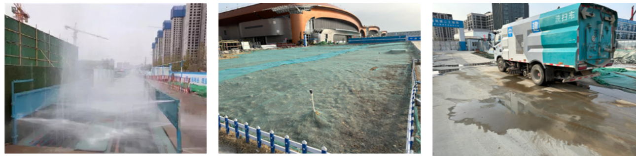
粉尘处理现场
