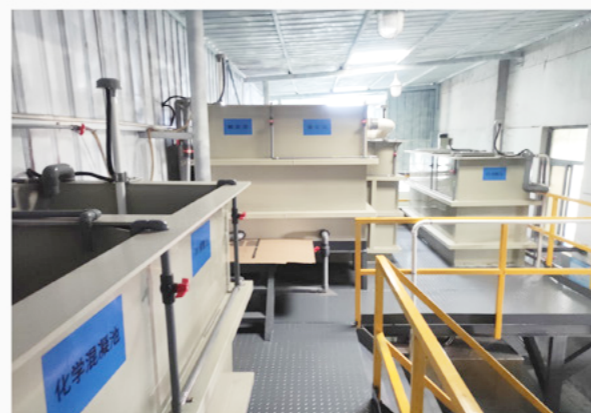
污水处理设施
