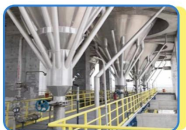
掺混料仓锥体及掺混室
