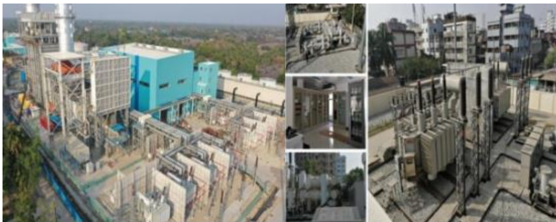
图 7：孟加拉 300MW 联合循环电站
